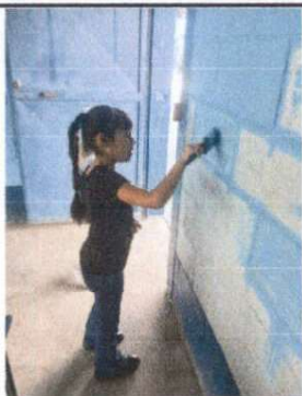
Foto 3: Pintura del interior de las aulas 1, 2, 3, 4, 5, 6, 7, 8, 9 10 del centro educativo
